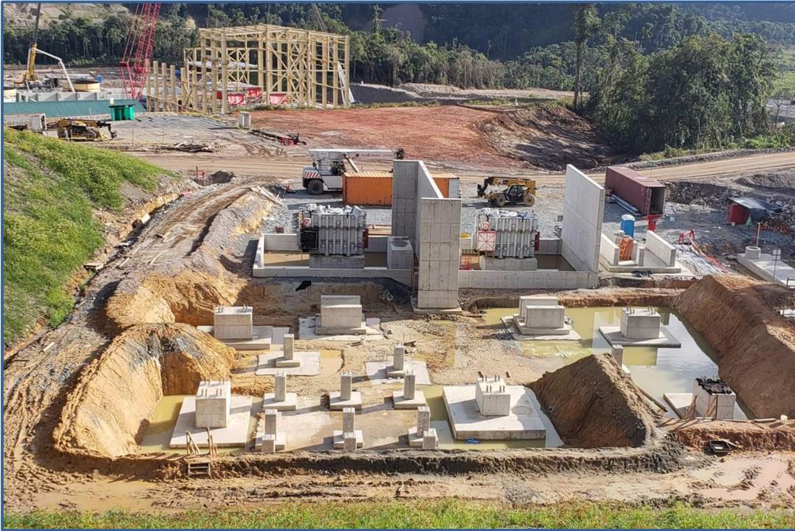
Figura 5. La subestación principal de Fruta del Norte está completa y los transformadores grandes se han colocado en sus cimientos.
